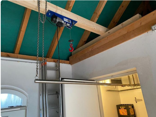
VERLÄNGERUNG NACH AUSSEN Rohrbahn durch die Zellenwand, davor ein Kettenzug zum Anheben
